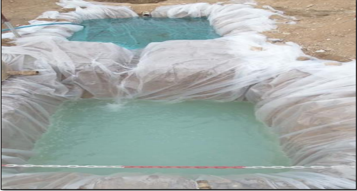
Şekil 43 Sondaj Çamuru Havuzu
